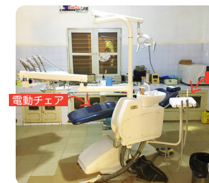
電気系統がショートした歯科ユニット
